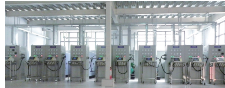
Prototype Testing Room / 发电机组真机试验室
