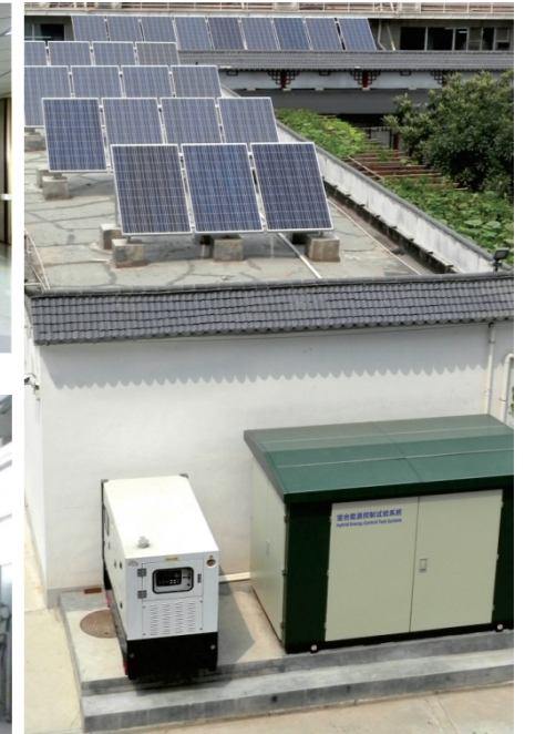
Hybrid Energy Control Test System 混合能源控制试验系统
