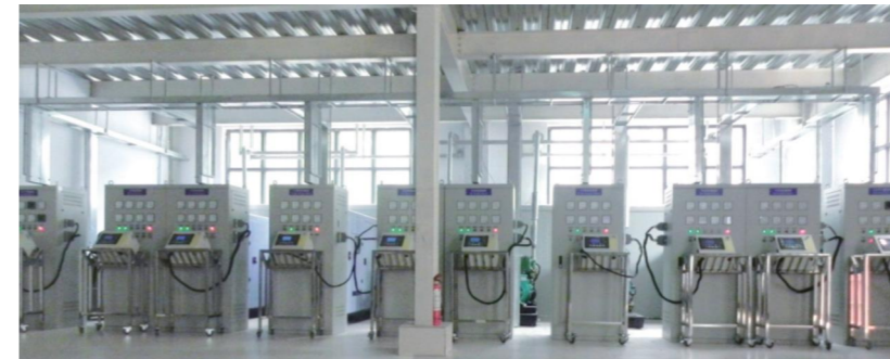
Prototype Testing Room / 发电机组真机试验室
