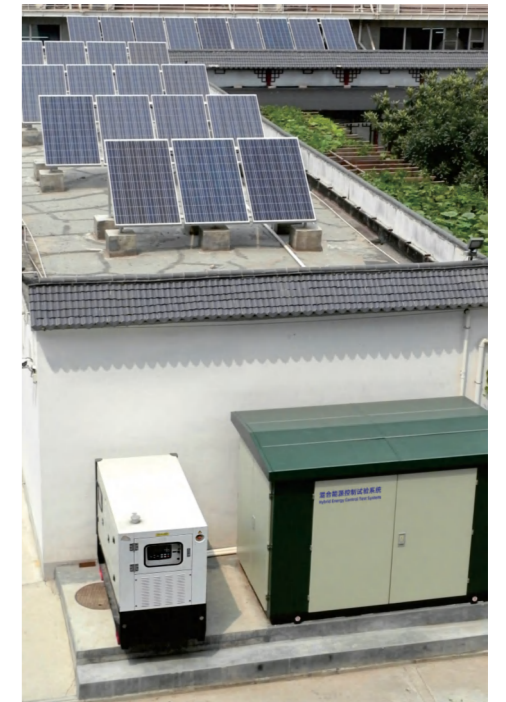
New Energy Control Testing System 新能源控制试验系统
