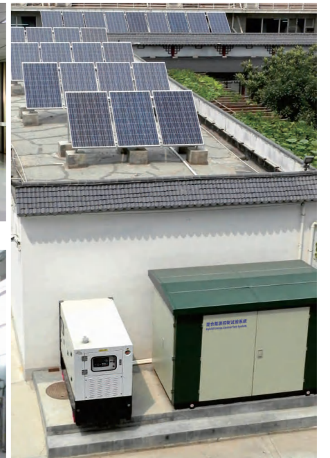
Hybrid Energy Control Test System 混合能源控制试验系统
