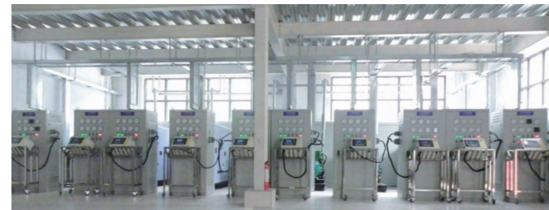
Prototype Testing Room / 发电机组真机试验室
